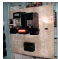
Support de compteur électrique en amiante-ciment
