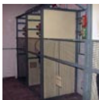
Logettes pare-étincelles en amiante-ciment
